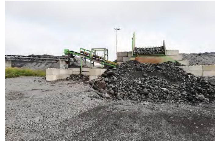
3 Frantumazione primaria e deferrizzazione
